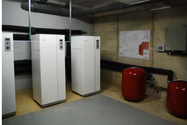
Sala de máquinas de la instalación de geotermia.
