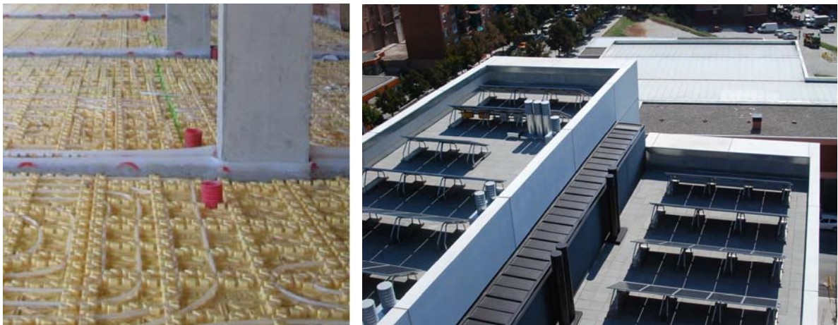
Suelo radiante y refrigerante. Paneles fotovoltaicos en cubierta.
